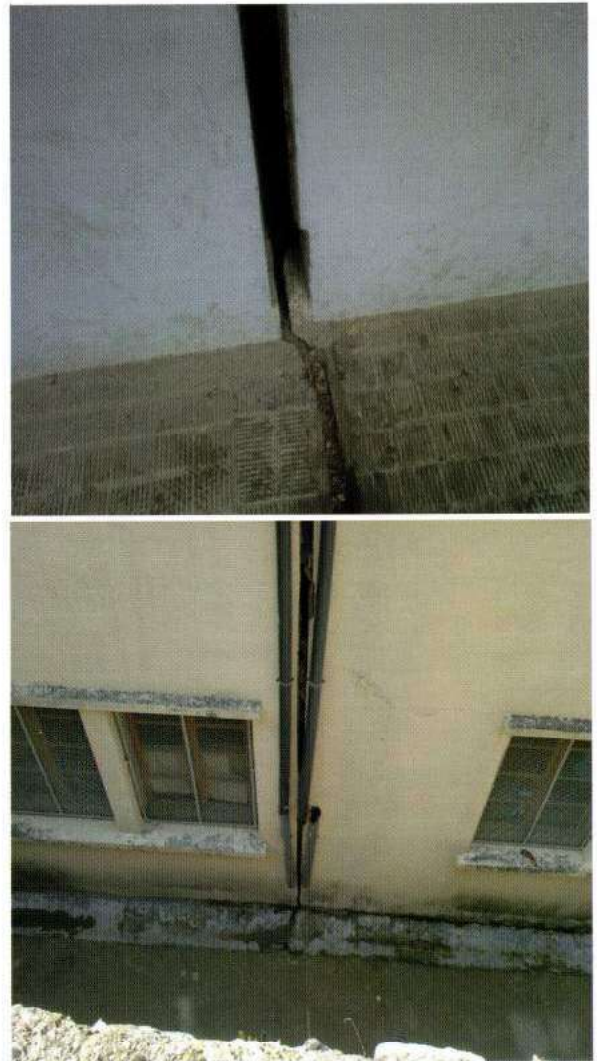
Figure 5: Ouverture des joints de dilatation : a)-construction à 3 niveaux ; b) au niveau de l'école d'Ain El Hammam.
