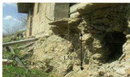
Figure 8 : a)-Vue globale de l'immeuble Taleb Gozali b)-niche d'arrachement à la limite aval de la construction.
