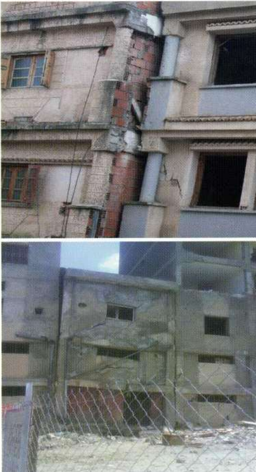
Figure 4: Basculement des blocs : (a) au niveau de la rue colonel Amirouche ; (b) de l'immeuble APC/CNEP.
