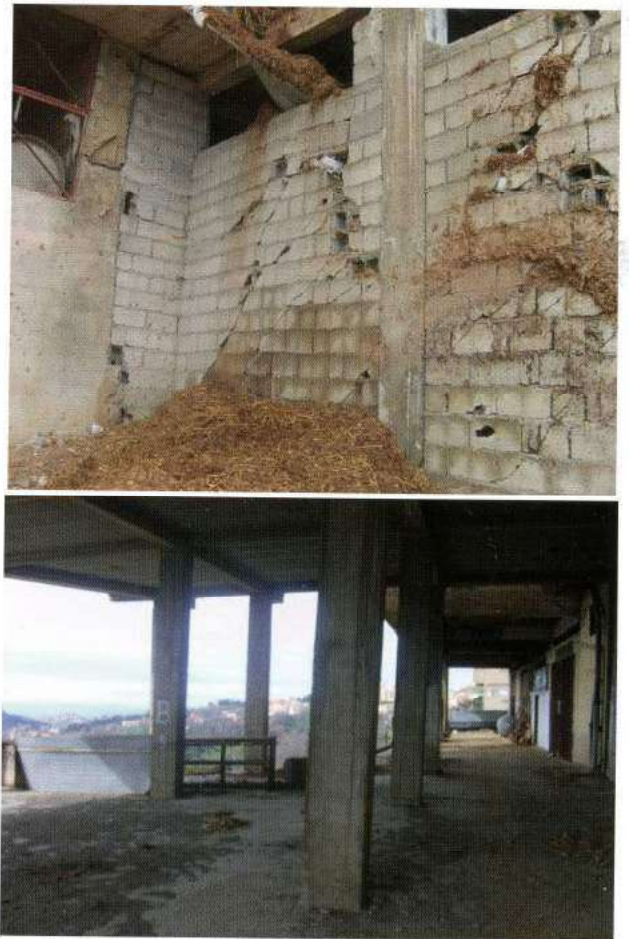
Figure 13: Dommage des cloisons et des poteaux des structures longues d'Ain El Hammam.
