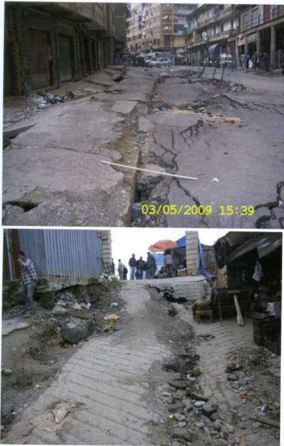
Figure 12 : Vue globale des désordres de la rue Bounouar et de la zone du marché.
