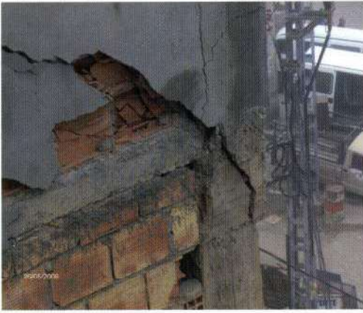
Figure 3 : Éclatement des nœuds (Poteau-poutre). Figure 3: Bursting nodes (pole-beam).
