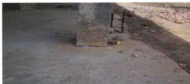
Figure 10 : Poteaux cisailés de l'immeuble Taleb Ahcène.
