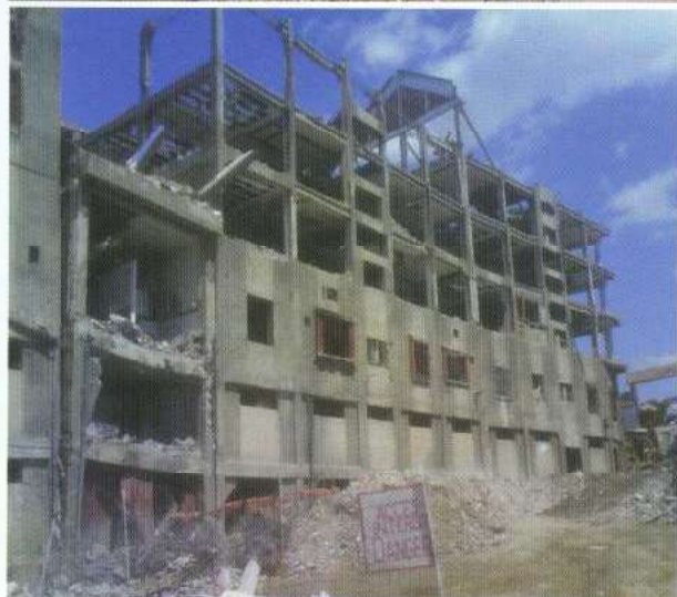
Figure 6 : destruction des bâtiments APC/CNEP : a)- bâtiments N°14 et 15 ; b)-bâtiment N°19.
