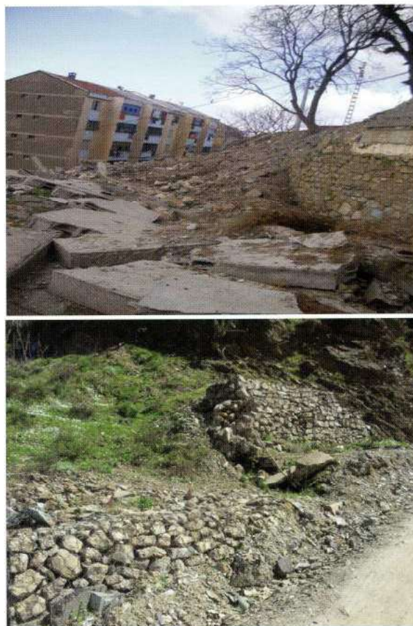
Figure 11: Désordre des murs de soutènement : a)-rupture du mur de soutènement dû à l'escarpement ; b)-cisaillement du mur en gabion.
