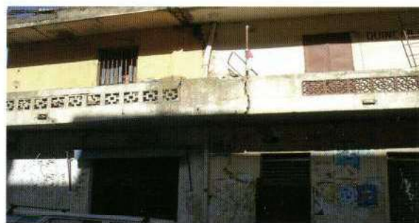
Figure 7. Les pathologies observées sur les immeubles Timssiline.
