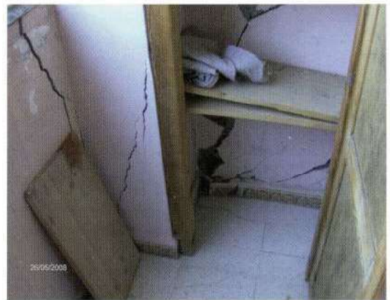
Figure 2 : (a) Des fissures obliques apparentes au niveau des fenêtres « bâtiment de la cité du marché », rue colonel Amirouche d'Ain el Hammam. (b) fissures en réseau d'une maison individuelle.
